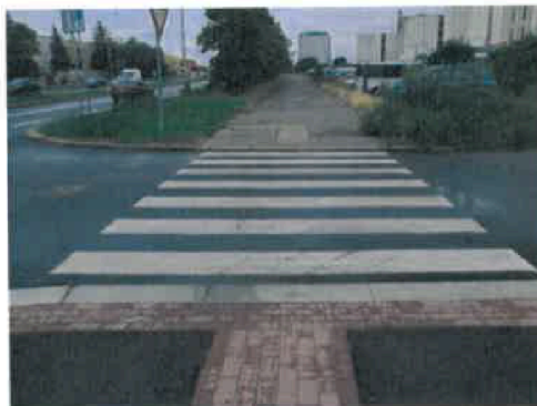
Obrázek 3: Přechod Zbudovská po malém dešti
